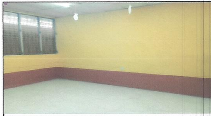
Foto 4: Las paredes se encuentran en proceso de pintarlas debido al deterioro de las mismas por la humedad por las lluvias.
