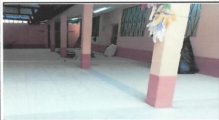
Foto 3: El piso de granito fue instalado, el cual se encontraba en malas condiciones debido a grietas y levantado del mismo
