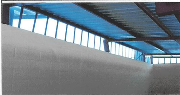
Foto 7: Las láminas están en proceso de instalación considerando que las mismas se encontraban en malas condiciones debido al deterioro y oxidación.
