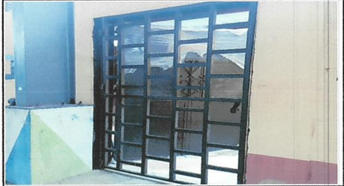
Foto 14: Se reparó e instaló la puerta de barrotes que tiene acceso a la entrada y salida de las instalaciones del establecimiento educativo
